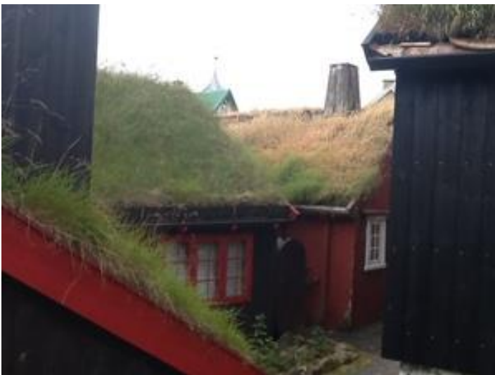
Grasisolatie op het dak.
